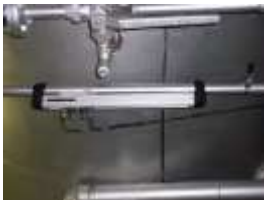
ボイラー給水流量測定
